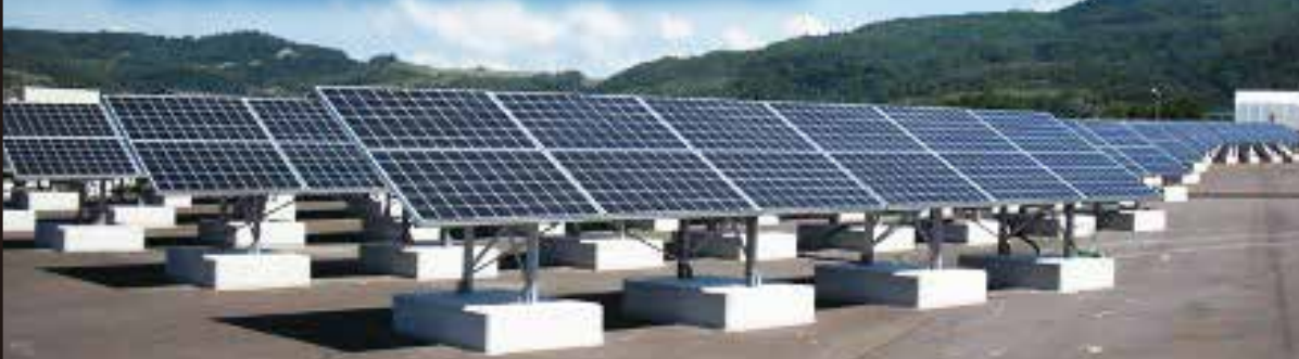
洞爺湖 メガソーラー発電所 (平成25年9月 施工)
