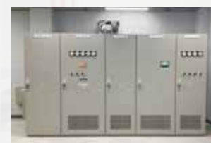
日高自動車道新冠町 大狩部トンネル受変電設備 (令和5年1月～令和6年3月 施工)
